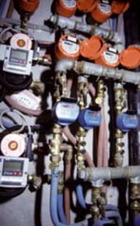
Armoire palière centralisant les compteurs de chauffage, d'eau chaude et d'électricité
