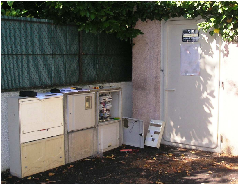
Vue d'ensemble poste cellules & TGBT Éclairage Public « Les Horts »
